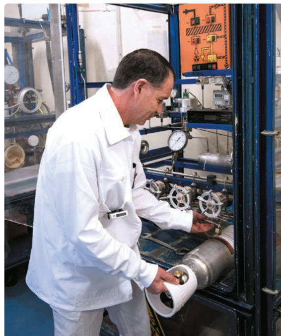
Mise en place d'une bouteille de ^{85}\text{Kr} vide © LEA Installation of an empty ^{85}\text{Kr} cylinder
